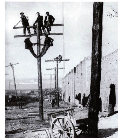
Ramón Claret. Tendido de cables de teléfono de la provincia de Barcelona. 1910.
