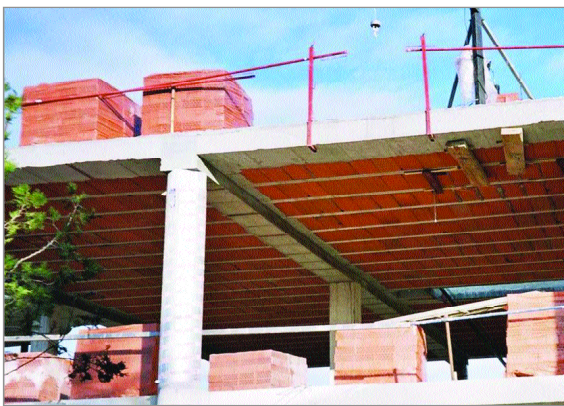
El incumplimiento de las normas (como en la fotografía anexa por falta de barandilla adecuada con riesgo de caída a distinto nivel) es generalizado y podría explicar la mayor siniestralidad laboral.
