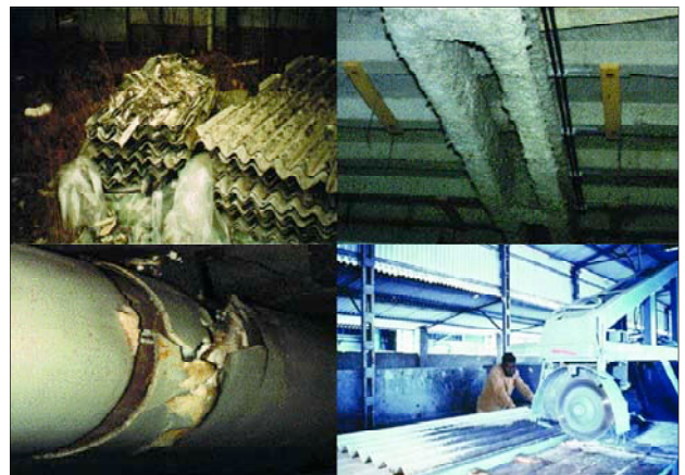
Usos diversos del amianto. De izquierda a derecha y de arriba abajo: almacenaje de uralita de fibrocemento deteriorado, techo con amianto flocado (amianto más cemento disparado a presión), tubería deteriorada con las fibras al aire y trabajador serrando placas de uralita de fibrocemento.
