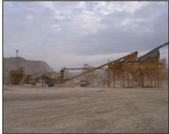
Planta de tratamiento (molienda, clasificación y carga de áridos).
