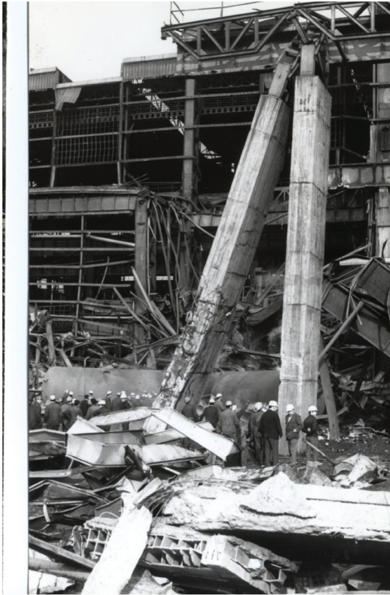
Se desplomaron dos pilares de la acería y los paneles metálicos de la fachada salieron volando en todas direcciones.
