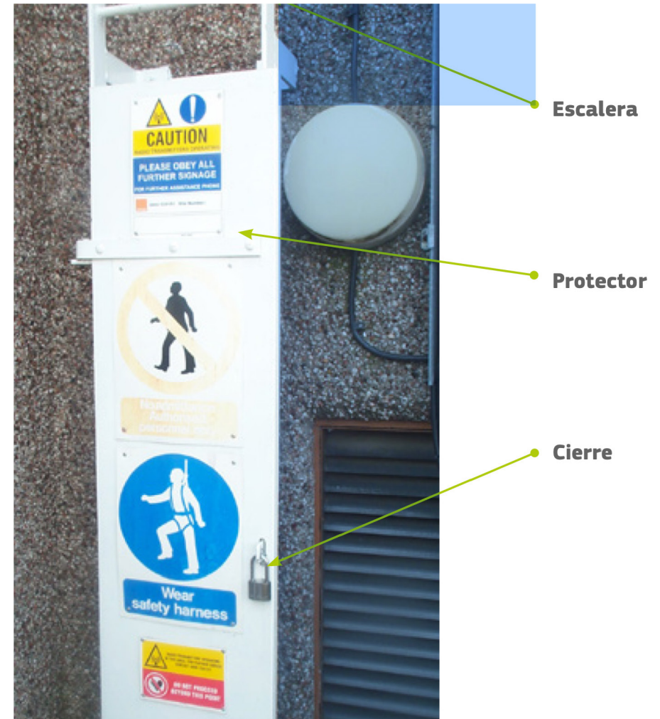
Ejemplo de protector para escalera de gato de acceso a azotea
